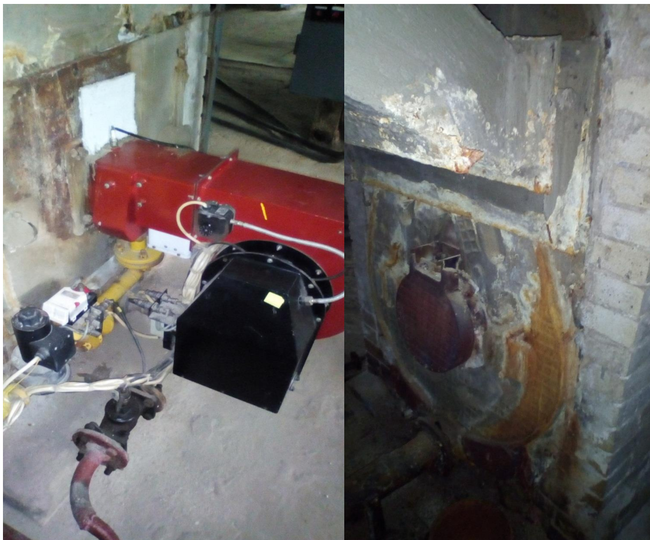
Рис. 7,8 - Следы обильного конденсатообразования на фронтальной и тыльной стороне котла «Факел»
