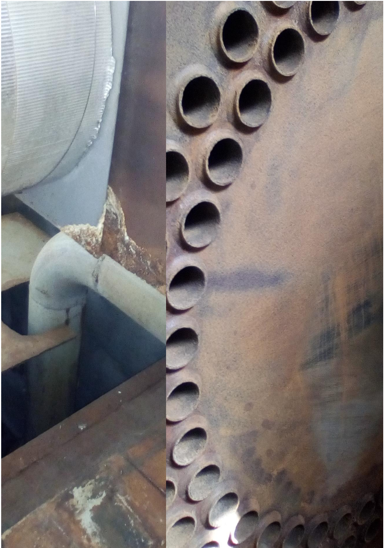
Рис. 7,8 - Следы коррозии и конденсатообразования на трубной части и заслонке котла .
