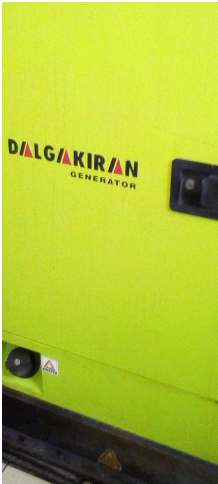
Рис. 10 – заправочная горловина резервной дизель-электростанции
