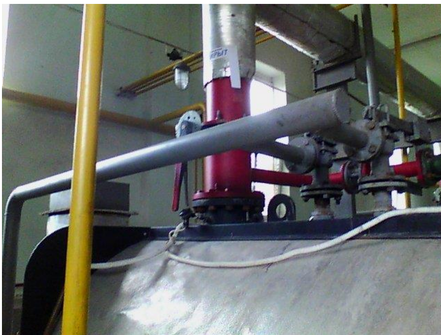
Теплопотери с неизолированных поверхностей оборудования и арматуры.
