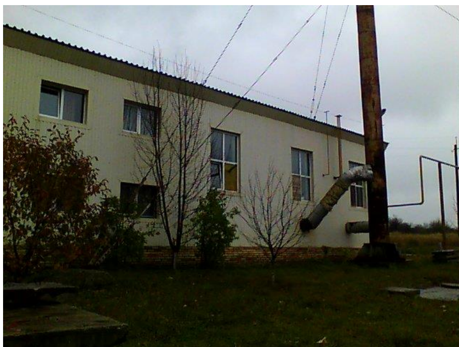
Равномерность температурного поля здания котельной.
